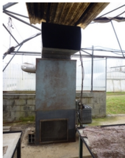
Chauffage au fioul à air pulsé
